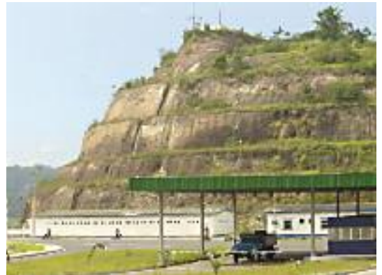
Solos Residuais de rochas sedimentares na Baía de Aratu, Bahia. Esse maciço, com mais de 40 m de altura, foi quase integralmente removido em 2010/2011, criando-se platôs nas cotas 4,0 m, 10,0 m e 16,0 m, para instalações industriais
