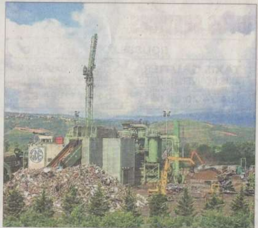
Vivre estime que les rejets de GDE ne sont pas conformes et demande l'arrêt provisoire de l'activité en attendant un reclassement du site.
