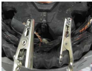
Messen der Ständerwicklung am Generator
