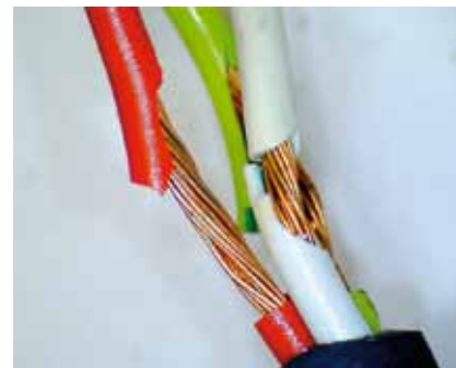
... und brüchige Isolierungen am Steckanschluss (Gefahr eines Kurzschlusses bei Bewegung).
